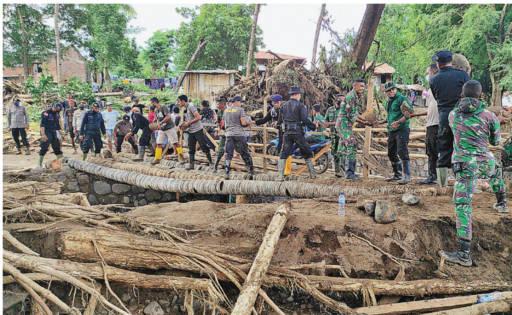
GOTONG ROYONG BANGUN JEMBATAN DARURAT: Anggota TNI dan Polri bersama warga setempat bergotong royong membangun jembatan darurat menggunakan batang pohon kelapa di Kecamatan Adonara Timur, Flores Timur, Nusa Tenggara Timur, kemarin. Jembatan darurat dibangun agar mobil pengangkut bantuan sembako untuk korban banjir bandang di wilayah Waiburak dan Waiwerang, Adonara Timur, bisa lewat.
